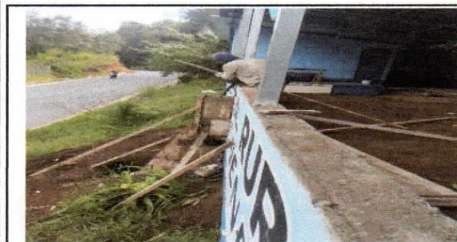
Foto 3: MURO PERIMETRAL EN RIESGO DE COLAPSO.
